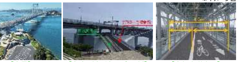
【全景】 【大鳴門橋に渡るアワイチ橋】 【自転車道空間】 兵庫県と徳島県の共同事業として、大鳴門橋の桁下空間を活用し、総延長1,799mの新たな自転車道を整備中
